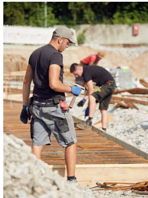
Die Arbeiter bewehren den Beton, der für eine lange Haltbarkeit der Stellfläche sorgen soll.
