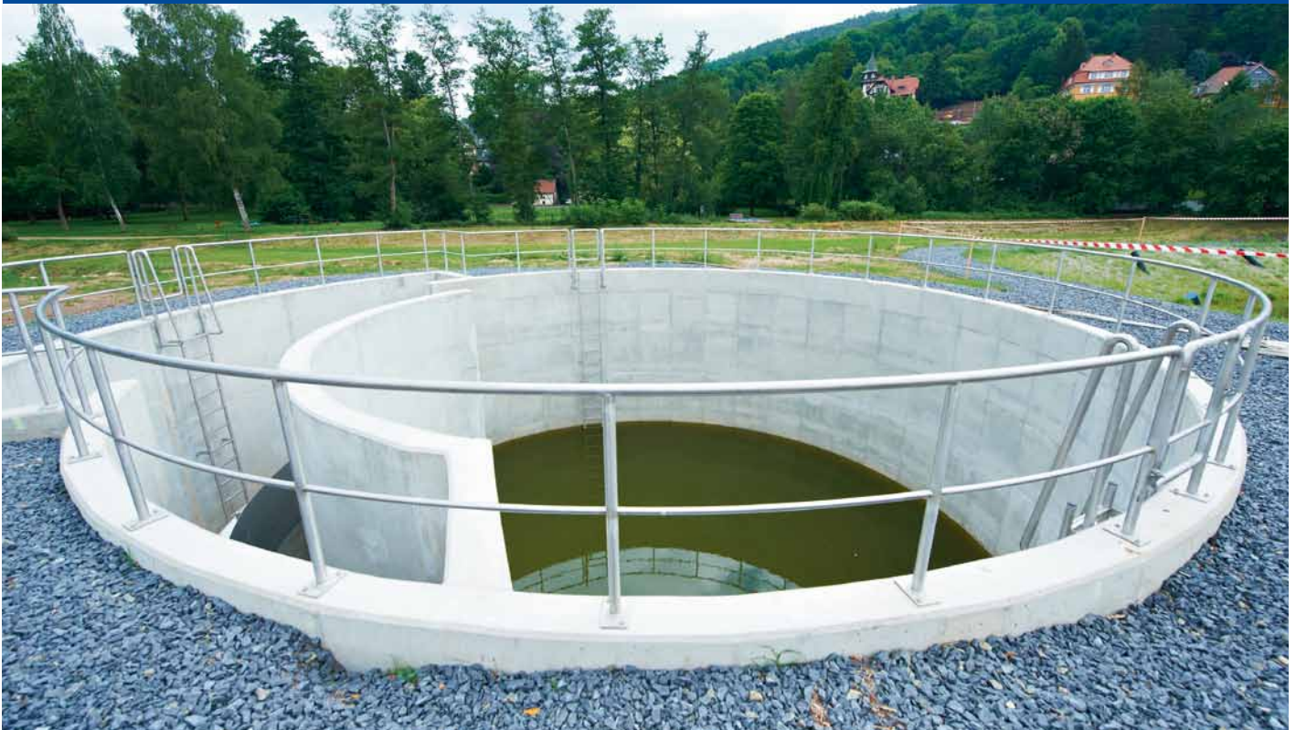
Moderne Sandfilteranlage auf dem Betriebsgelände der Odenwald Faserplattenwerke (OWA) in Amorbach.
