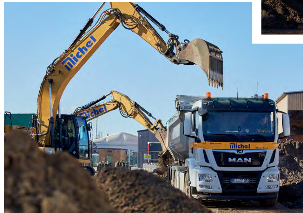
Erdberge, so weit das Auge reicht. Mit 16.000 m 3 Aushub war die Bagger- und LKW-Flotte bestens beschäftigt.
