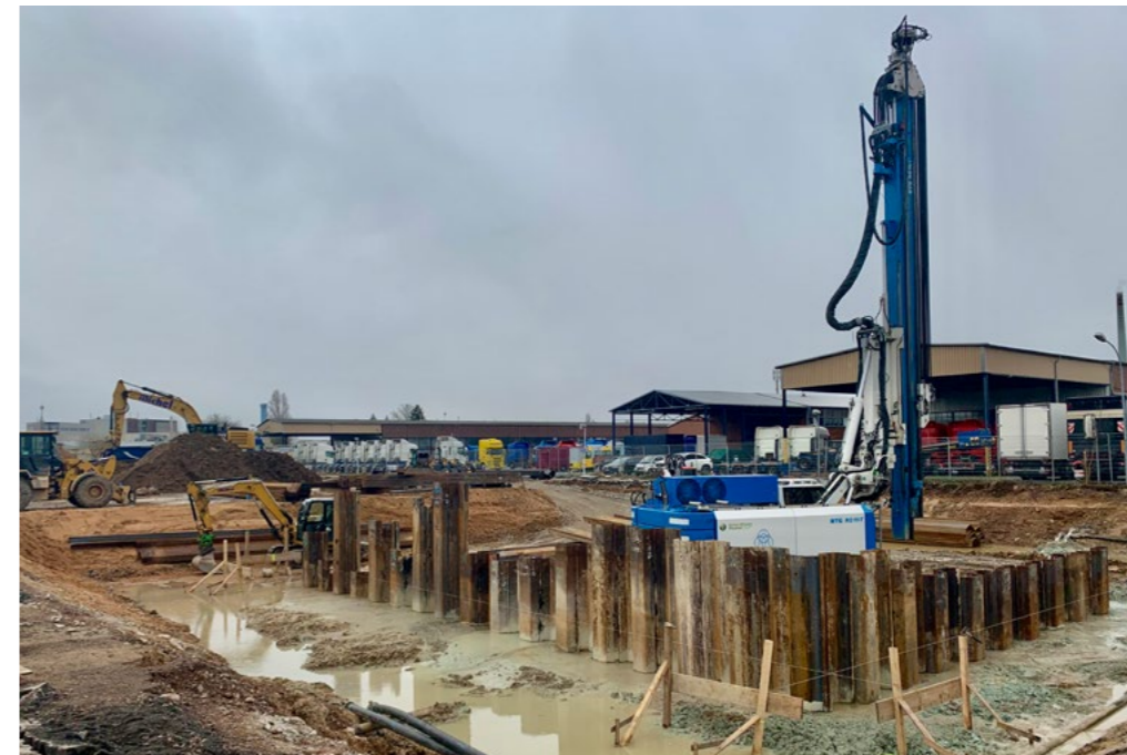
Auf der Baustelle waren eine mäklergeführte Ramme zum Einsetzen und Entfernen der Spunddielen sowie ein 300 Tonnen Mobilkran mit Rüttler freireitend zum Ziehen der Spundbohlen im Einsatz.
