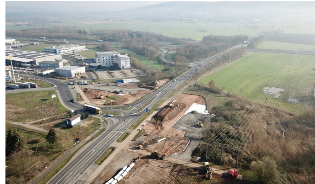
Am Verkehrsknoten direkt neben dem Autobahnanschluss Karlstein baut Michel Bau ein aufwendiges Kreisellaubauwerk mit begleitenden Radwegen und drei Unterführungen für Fußgänger und Radler.
