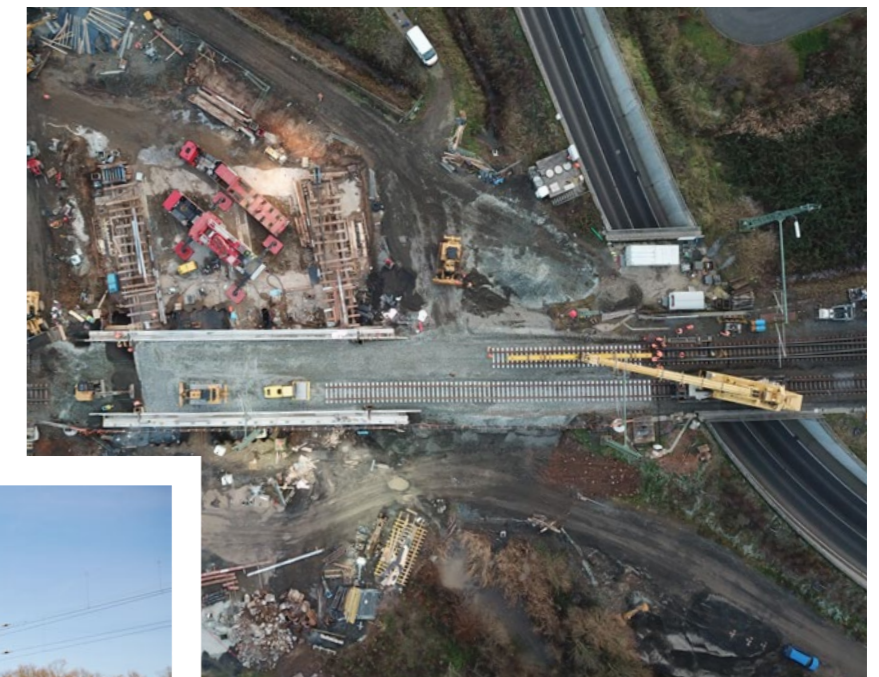
Die ICE-Brücke in Gelnhausen ist als Flutbrücke auch für den Hochwasserfall gerüstet. Sie verfügt über einen Durchlass, der das Wasser zielgerichtet weg von den Wiesenbereichen neben dem Bahndamm, der Autobahn A66 und der Stadt Gelnhausen leitet.
