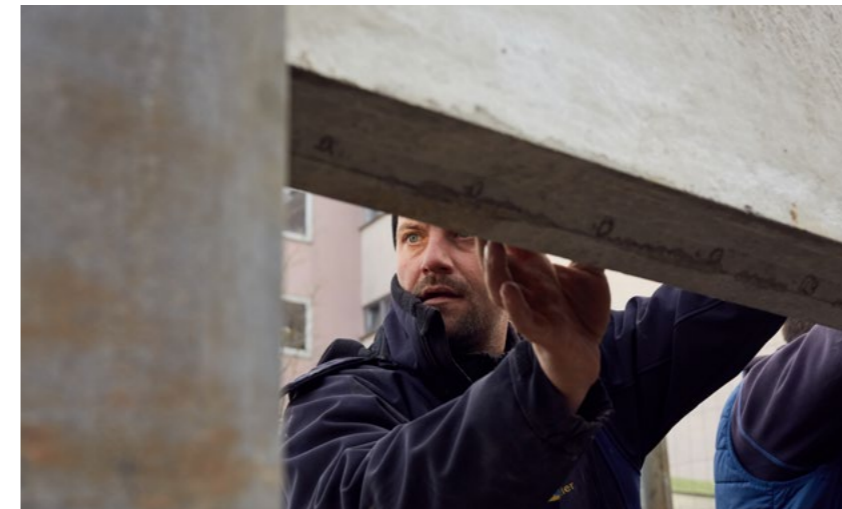
Nachträglich verringerte Einbautoleranzen machten die Stahlarbeiten am Parkdeck in Aschaffenburg zur echten Millimeterarbeit.
