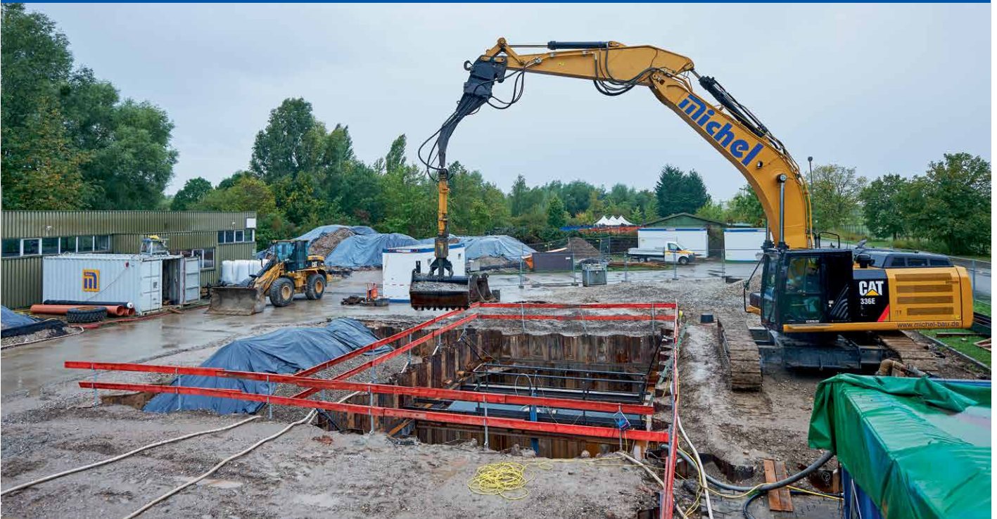
Der individuell für diese heikle Sanierungsaufgabe konstruierte und gefertigte CAT 336E Bagger mit Spezialausrüstung ist in der Lage, selbst bei einer befestigten Baugrube zuverlässig und im Dauerbetrieb in 7,5 m Tiefe zu arbeiten.
