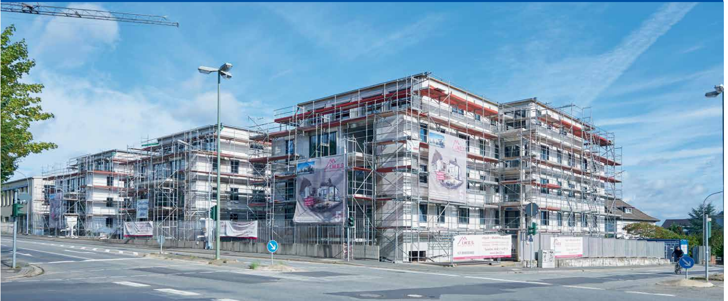
Die Rohbauten der Mehrfamilienhäuser in Gießen zwischen Leihgesterner Weg und Aulweg sind bereits sehr weit fortgeschritten.
