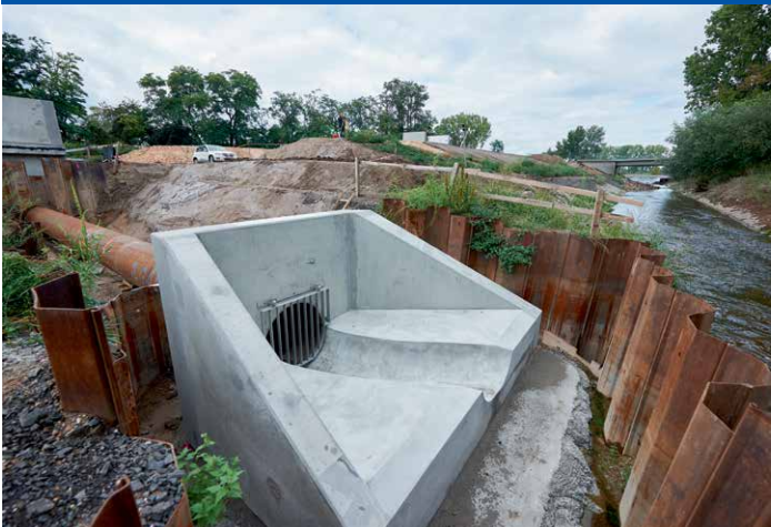
Einlaufschacht, um das Oberflächenwasser des nahegelegenen Industriegebiets aufzufangen.
