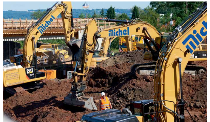
Es geht schnell voran. In nächster Zukunft werden sämtliche Baumaschinen von Michel Bau mit der Innovation VisionLink ausgerüstet sein.
