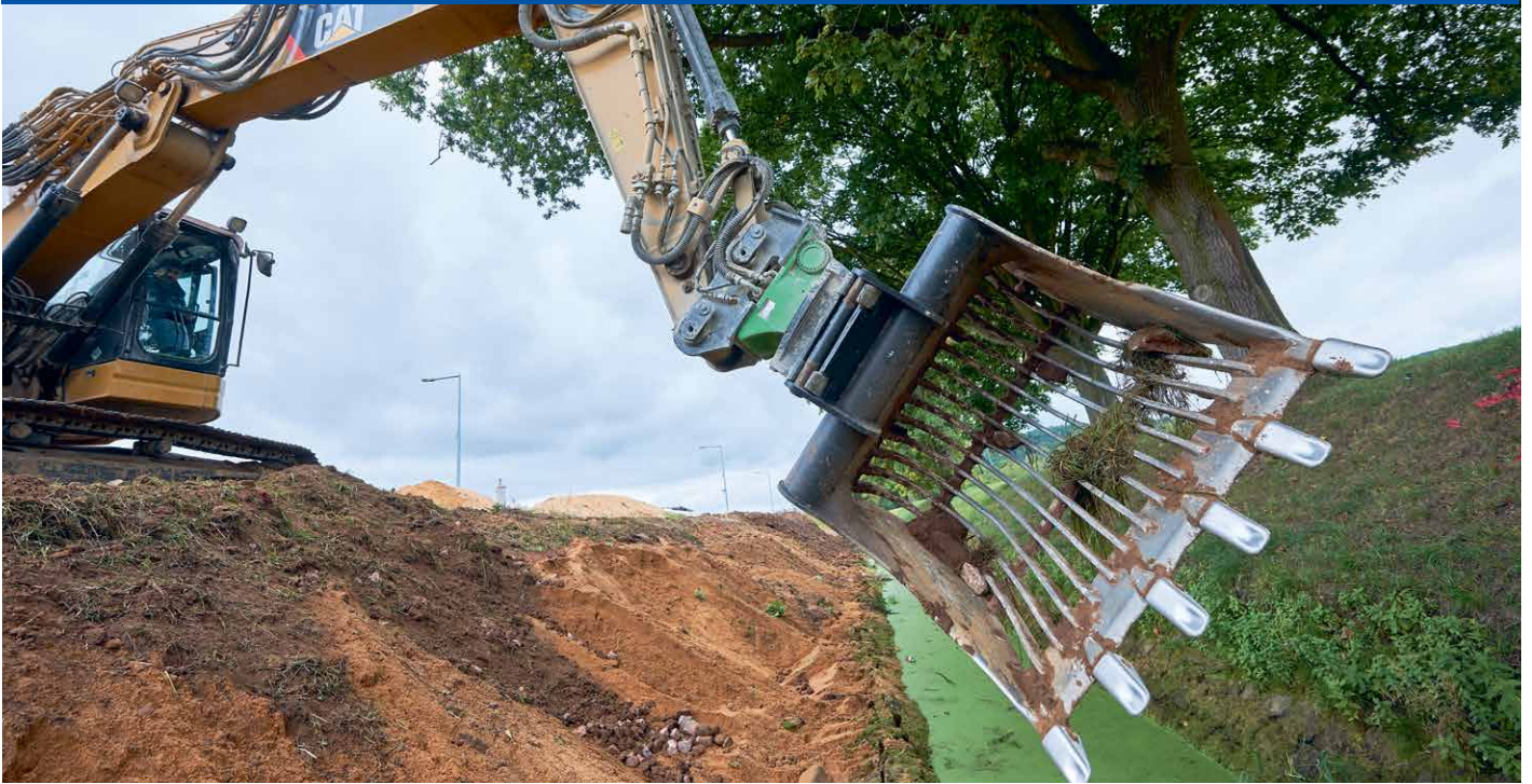
Alles dreht sich um den Tiltrotator. Bei Böschungsarbeiten von Michel Bau in Großwallstadt bewährt sich diese innovative Technologie im Einsatz.
