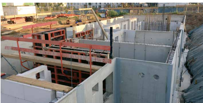
Solide Basis der Wohnanlage in Aschaffenburg: Auf dem von Michel Bau realisierten Fundament entsteht das Kellergeschoss.
