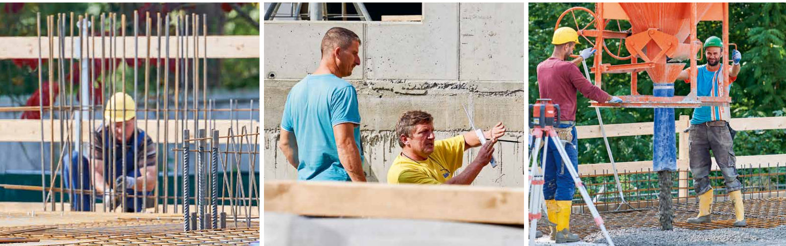
Auf der Baustelle wird konzentriert und professionell gearbeitet. Zeitweise befinden sich bis zu 20 Spezialisten von Michel Bau auf der Großbaustelle in Gießen.
